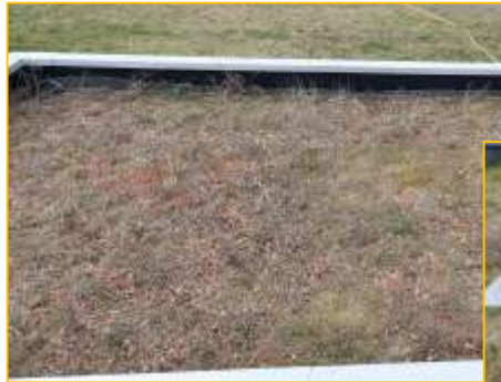
Dach 1– Zustand sehr dürrtig Kaum Triebe, Pflanzen überwiegend braun
