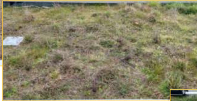
Dach 2 – Zustand mäßig Großteil der Pflanzen treibt aus, vereinzelt braune Stellen.
